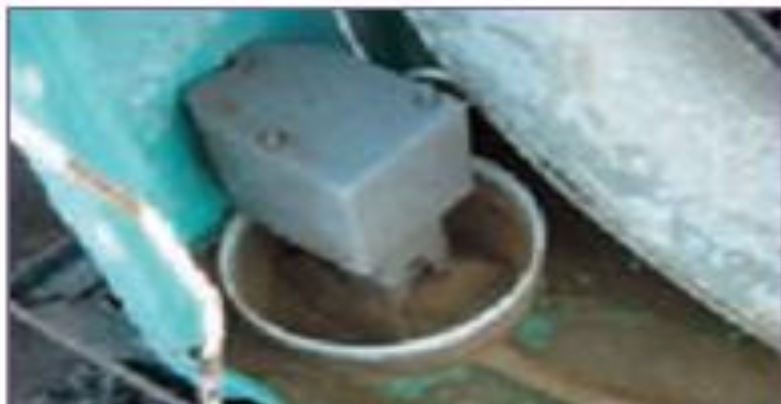
ج - بررسی و تمیز کردن پمپ آب
