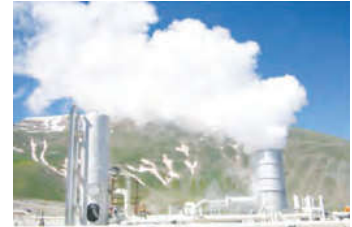
شکل ۱۰- نیروگاه زمین گرمایی مشکین شهر که با توان تولیدی ۱۰۰ مگاوات نصب شده است.
