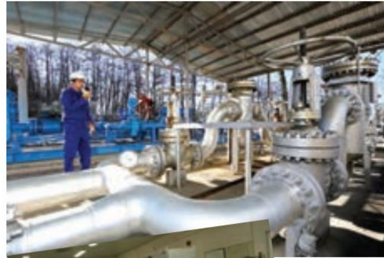
منطقه شمال، ایستگاه فشارشکن لاجیم
