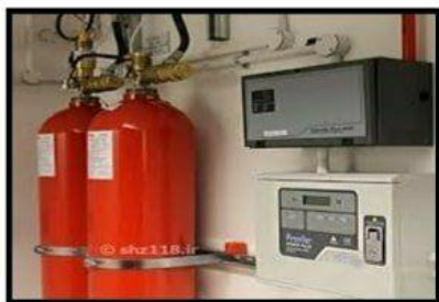
تاسیسات آتش نشانی
