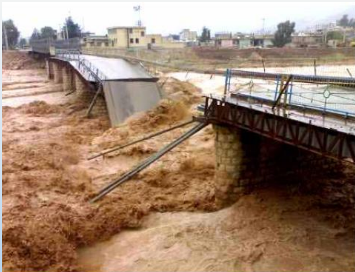
خریب پل در اثر سیلاب منطقه کنشت در استان کرمانشاه
