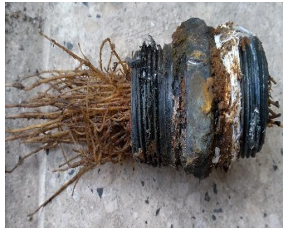
نفوذ تارهای کشنده درخت درون لوله آب
