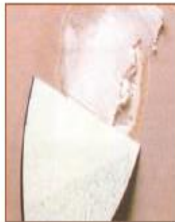
ب - لکه گیری و ترمیم ترک‌ها
